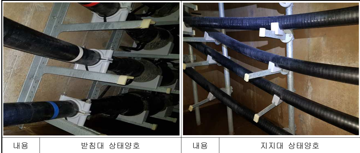
【사진 5.8】 부속 및 부대설비 현황
