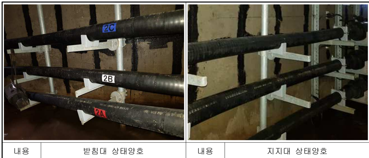
【사진 5.16】 부속 및 부대설비 현황
