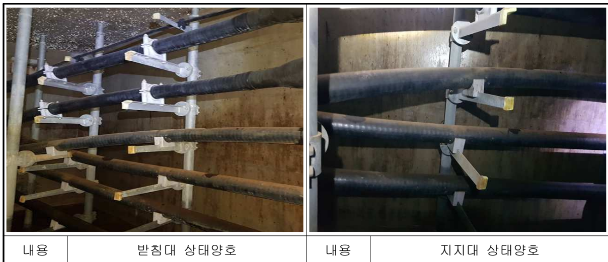
【사진 5.12】 부속 및 부대설비 현황
